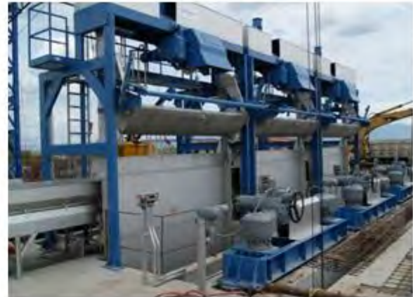
PLANTA DE BOMBEO CASA COLORADA PROFUNDA
