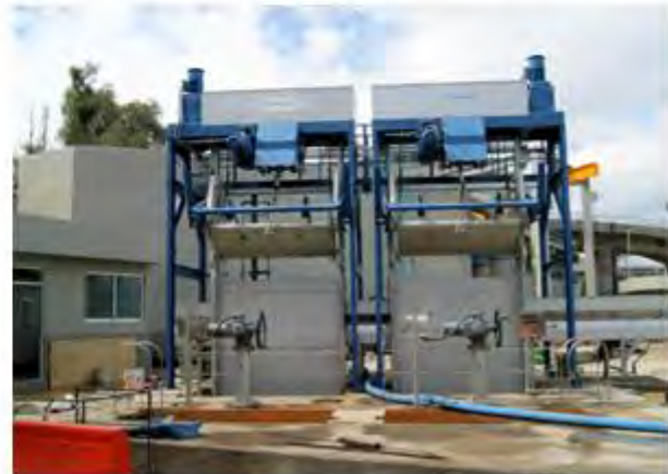
PLANTA DE BOMBEO MUYUGUARDA MÉXICO DF
