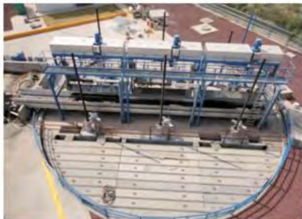
PLANTA DE BOMBEO LA CALDERA EDO. DE MÉXICO
