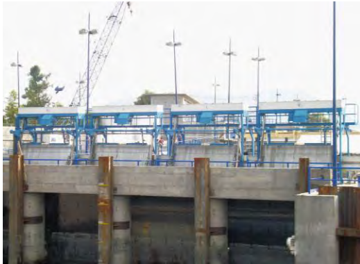
PLANTA DE BOMBEO GRAN CANAL KM 11+600
