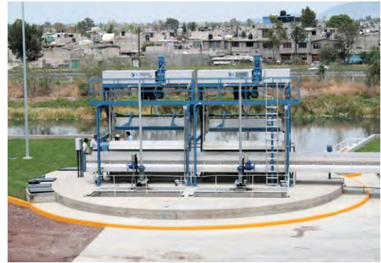
PLANTA DE BOMBEO CASA COLORADA SUPERFICIAL EDO. DE MÉXICO
